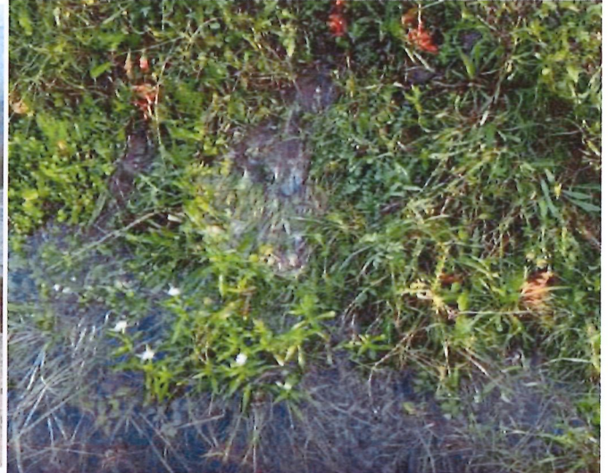
Infiltration dans la digue
